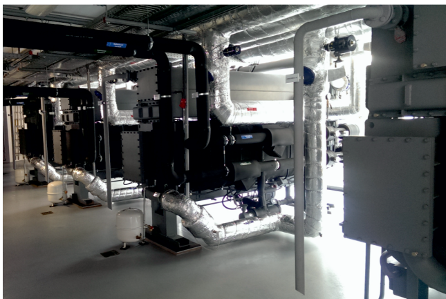
Absorber-Kältemaschine im Institut für Arbeitsschutz der DGUV in Sankt Augustin
