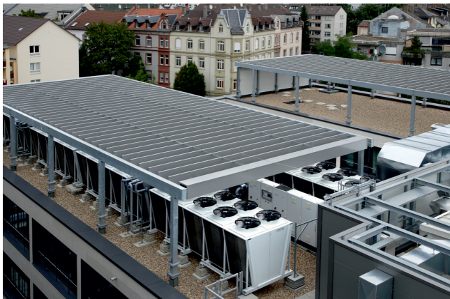
Freikühler Rechenzentrum Deutscher Wetterdienst in Offenbach
