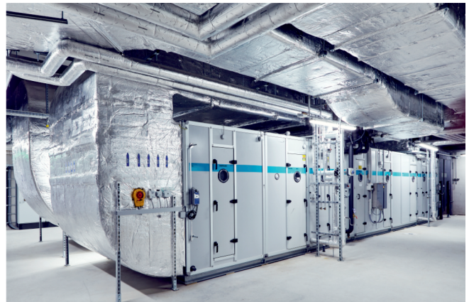
Lüftungszentrale Kirsch Pharma Bissendorf
