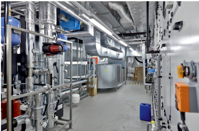
Lüftungszentrale Theater Gütersloh
