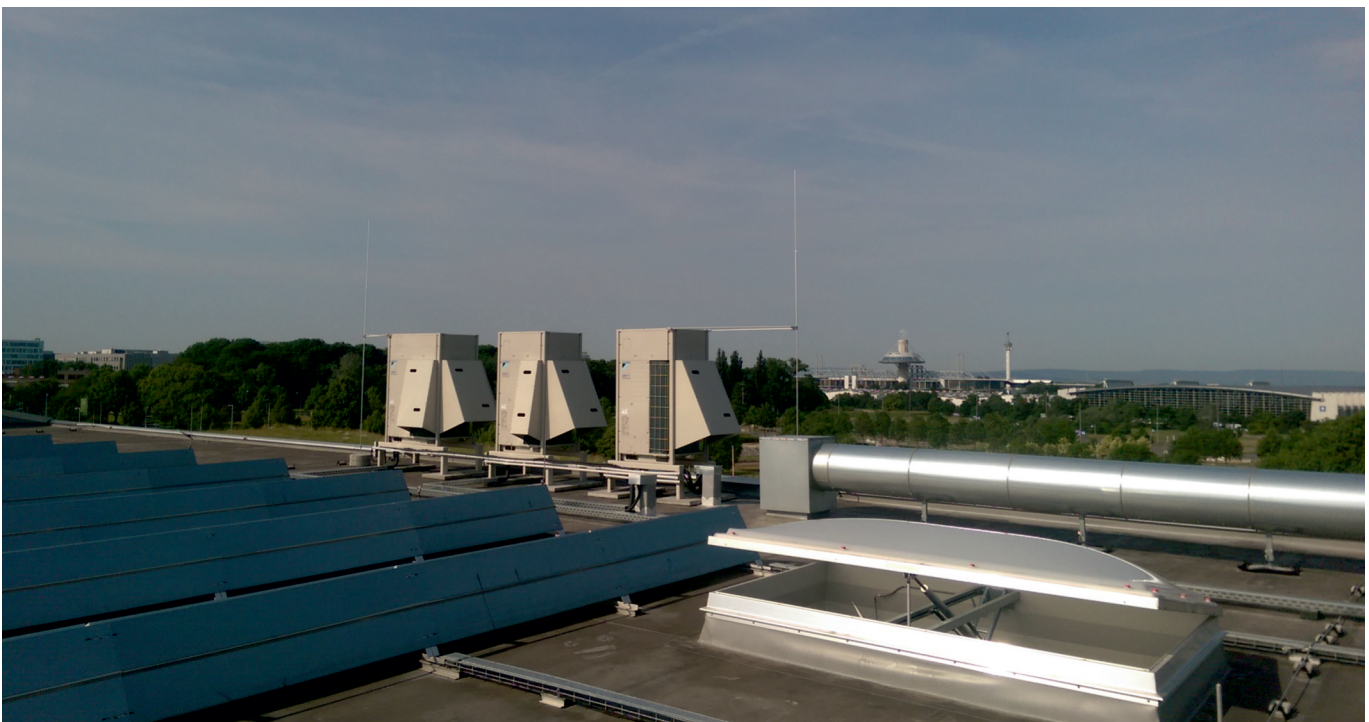
Außeneinheiten einer VRF-Anlage bei Arvato in Bemerode
