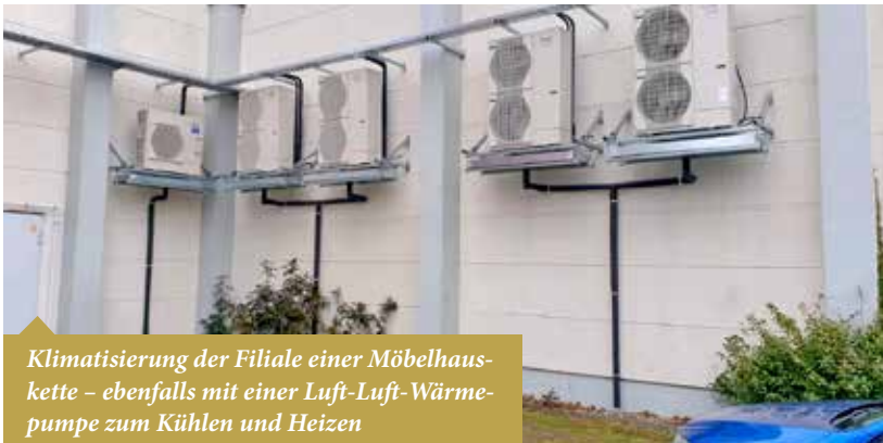
Klimatisierung einer Logistikhalle mit einer Luft-Luft-Wärmepumpe von Mitsubishi Electric
